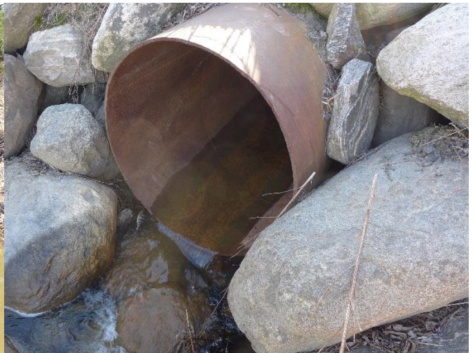
Photo prise le 24 avril 2013 Perchaude coincée à gauche du ponceau
