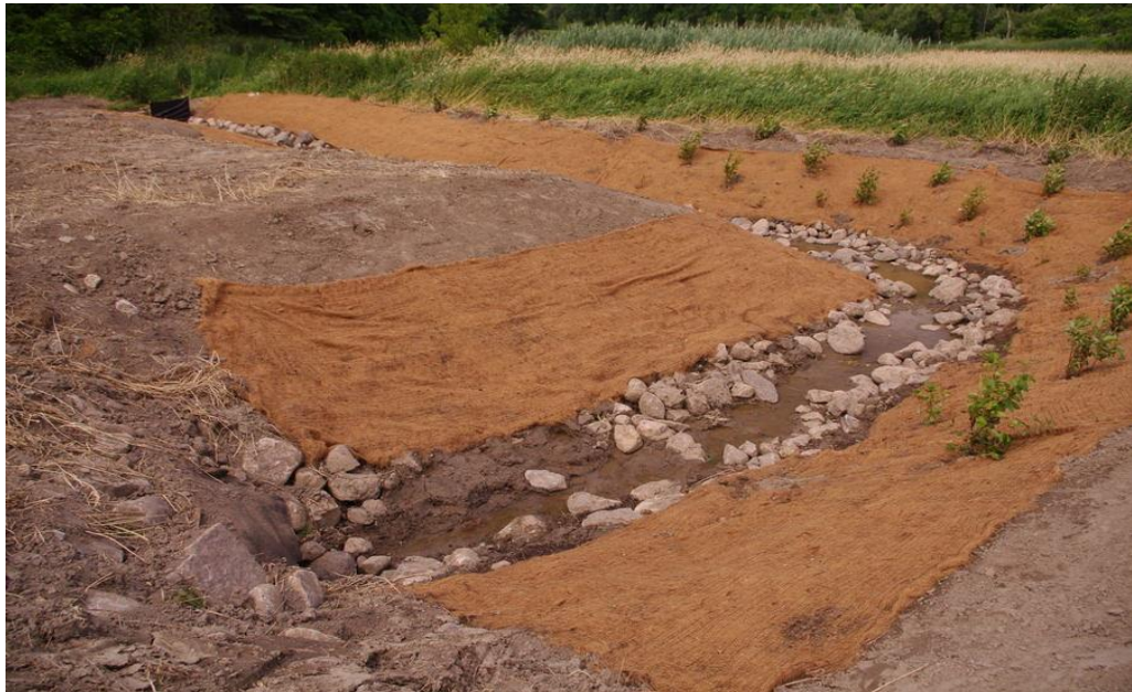
Photo 7 Marais I, 2014. Les travaux d'aménagement consistaient en un reprofilage du cours d'eau, la déposition de pierres dans le fond et sur les rives et une entière révégétalisation du site d'intervention.
